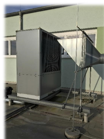
Luft-Wasser-WP mit FOL am Lufteintritt
