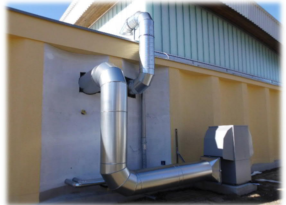
Luft-Wasser-WP mit FOL (RLT) vor Ansaugung
