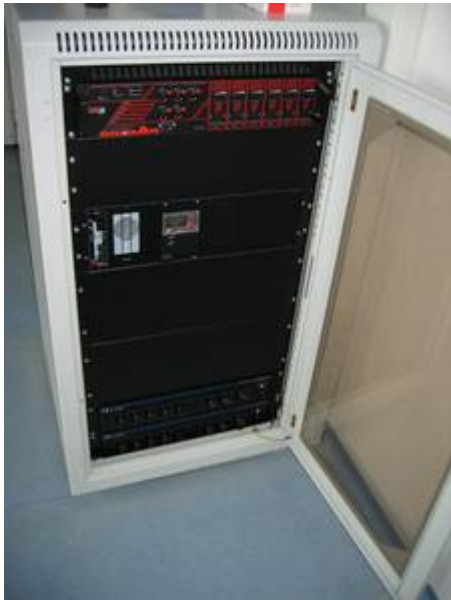
Zentrale der elektroakustischen Anlage
