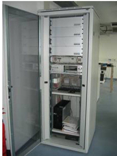
Zentrale der Multikommunikationsanlage
